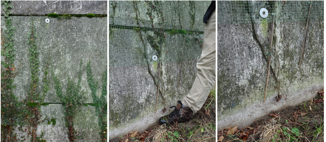
Figuur 7. Doordat de voet van klimplanten onbeschermd tegen de geluidswal staan wordt tijdens het maaien soms de plant aan de voet afgemaaid en/of beschadigd, waardoor de plant afsterft. Op de middelste foto is te zien dat de stam is weggemaaid op de plaats waar de voet is afgebeeld, wat uiteraard niet de bedoeling kan zijn. Het aanbrengen van een wat bredere laag houtsnippers ten behoeve van de vochthuishouding (zoals hierboven beschreven), kan als positief neveneffect zorgen dat de jonge aanplant beter opvalt tussen de overige bermvegetatie. “Ongelukjes” zoals op de foto’s zullen dan hopelijk minder snel gebeuren. Een ander alternatief is het aanbrengen van een barrière vershil, zodat de maaier er niet direct langs kan rijden, bijvoorbeeld in de vorm van een betonband. Een maatregel die praktisch gezien omslachtig is.
