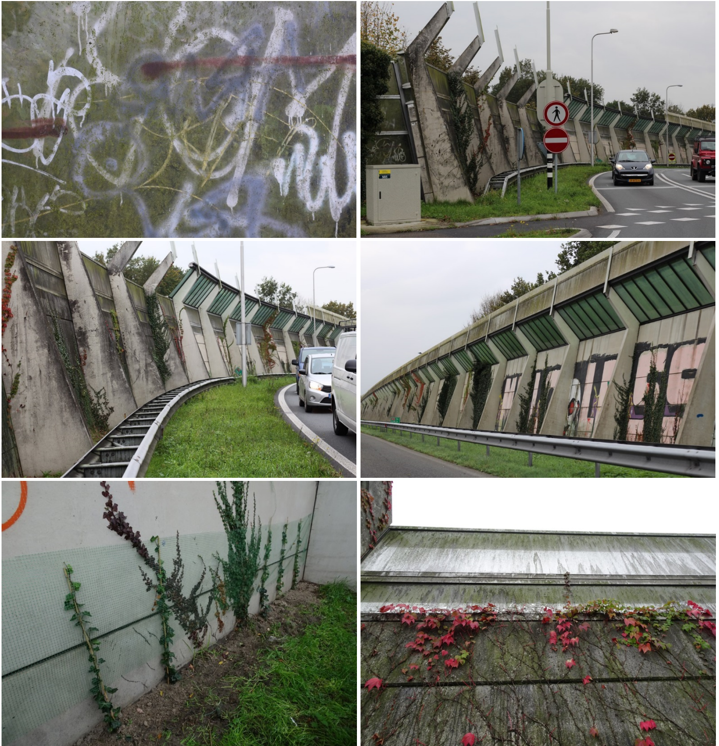
Figuur 8. Geluidsscherm 2 is opgebouwd uit betondelen i.c.m. glas. De ooit doorzichtig glazen panelen waren bedoeld om het achterliggende landschap langs de Linge te kunnen bewonderen. Door de algengroei en achterstallig onderhoud is dit niet meer mogelijk.
